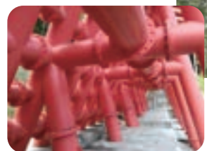
砂防ダムとしては珍しい鮮やかな朱色の鋼製フレームで造られた「ガン沢砂防堰堤」。
